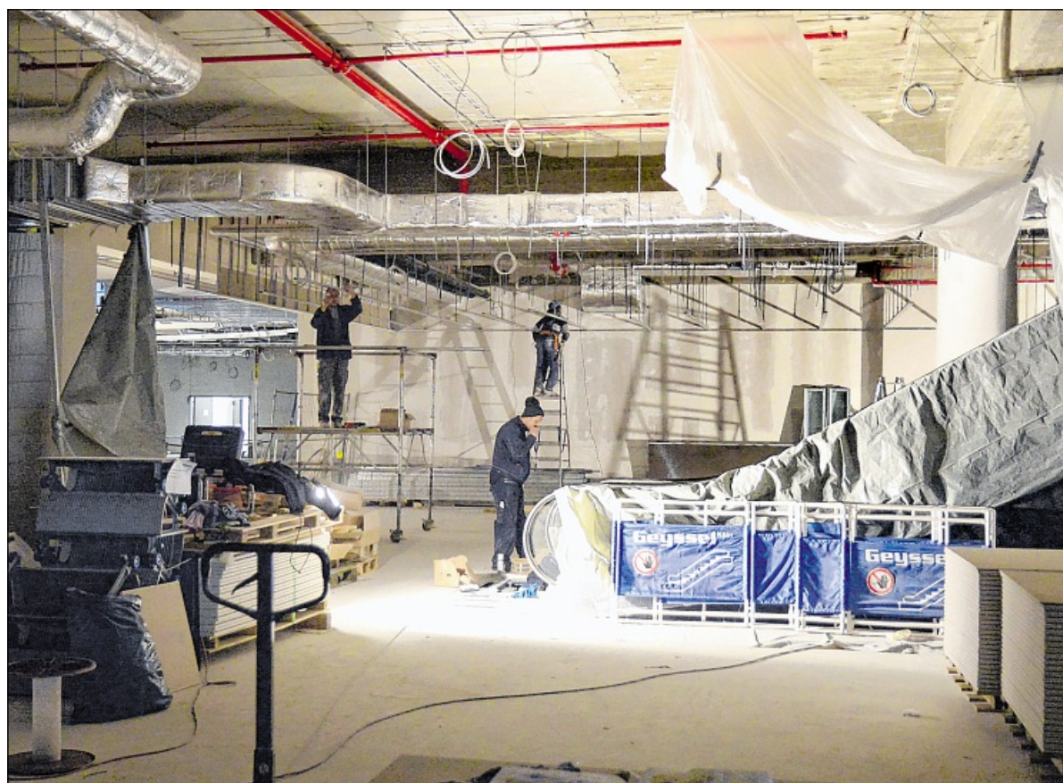
KABEL, DECKEN, BÖDEN UND ROLLTREPPEN: Der Innenausbau läuft auf Hochtouren. Mindestens 200 Handwerker arbeiten auf allen Ebenen des neuen Einkaufsparadieses. Fotos: Collet
