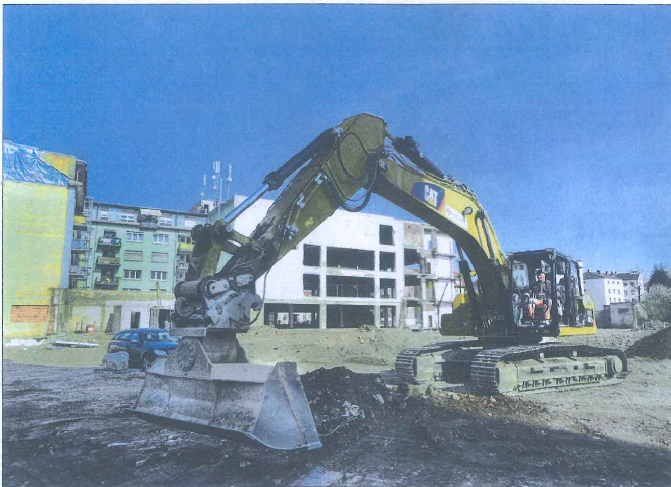
DIE BAGGER ARBEITEN WIEDER: Auf dem Gelände der künftigen Schlossgalerie haben gestern die Bauarbeiten für das Einkaufszentrum begonnen. In den nächsten 18 Wochen sind Unterfangungsarbeiten und Erdaushub der Baugrube vorgesehen. Foto: Collet
